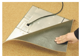
▲全ての器械のコードを床に埋め込むOAフロアを採用している。
